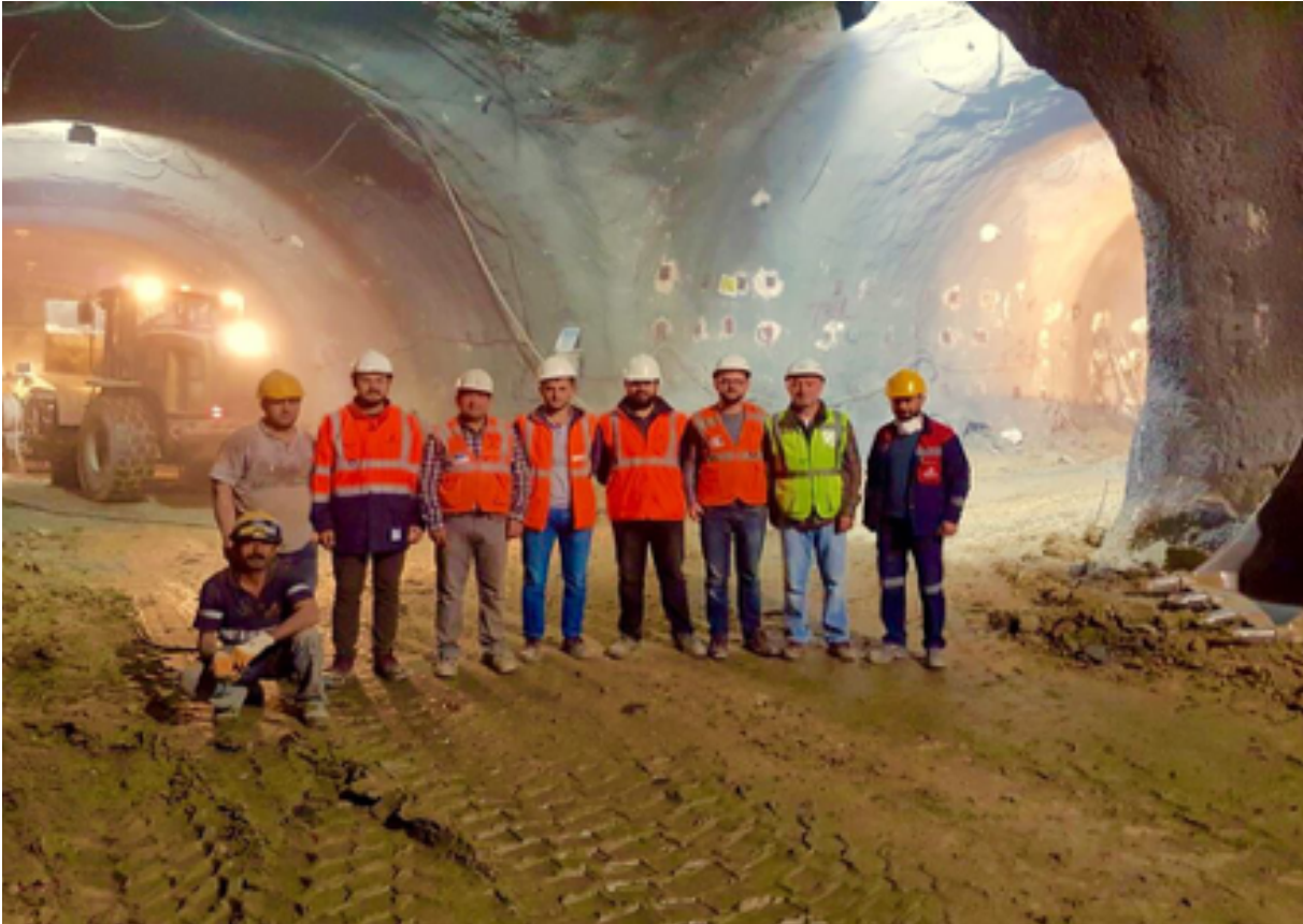
İhlasyuva Şantiyesi, Şantiye Şefi ( Ali Dağlı ) , Elektrik Şefi ( Volkan Alaidinoğlu ) , Makine Mühendisi ( Dođukan Akbal ) , Mütcaahhit Firma Vardiya Mühendisi ( Ahmet Uçar ) , Vardiya Mühendisleri ( Erdem Aycan, Serol Erođlu ) ve Tünel çalıřanları
